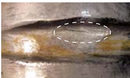
Рис. 7. Подтверждение обнаружения трещины после вскрытия шва перед ремонтом
